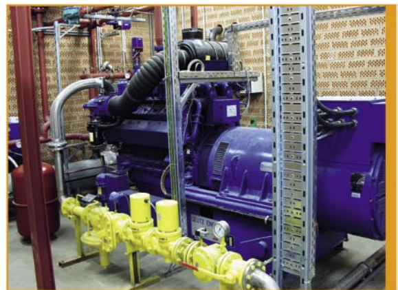
Sähkön- ja lämmöntuotantoyksikkö rakennuksessa
