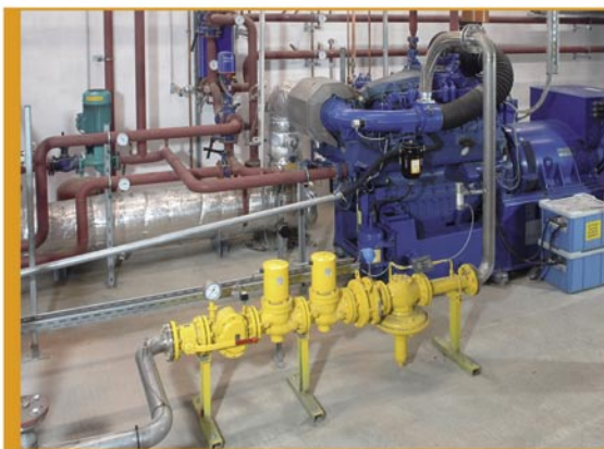
Sähkön- ja lämmöntuotantoyksikkö rakennuksessa
